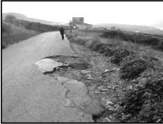
Figura 4. Particolari di una zona in frana in località S. Antonio Some details of S. Antonio landslides
