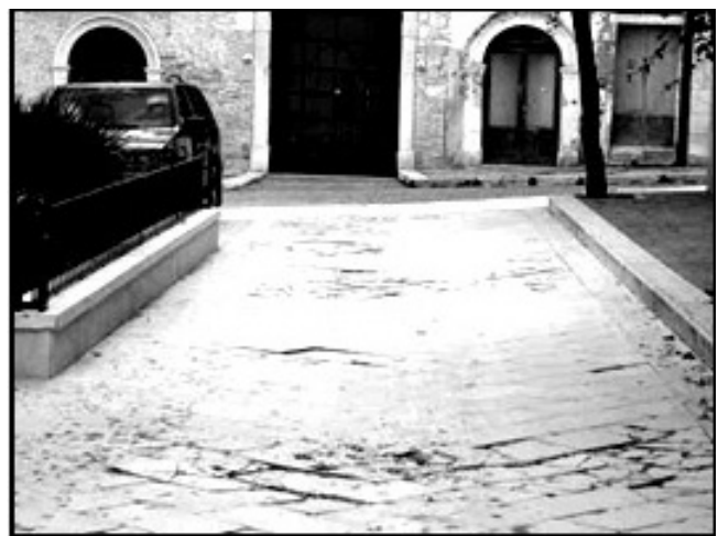
Figura 3. Dissesti della pavimentazione, a lastre di pietra, nel centro storico
